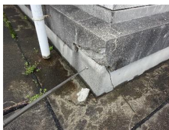
校舎：屋上のひび割れ
