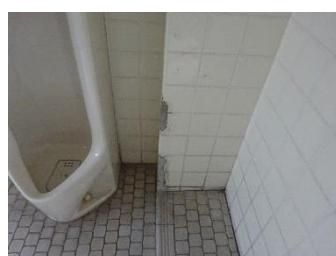
トイレ：タイルの破損
