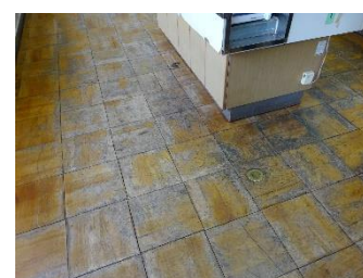
校舎：床の劣化
