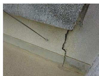
校舎：壁のひび割れ
