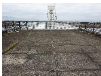
校舎：屋上の劣化
