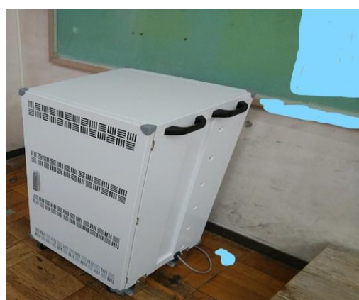
東小学校充電保管庫
