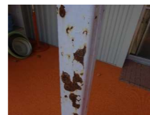
柱の錆・劣化
