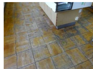
床仕上げの劣化状況
