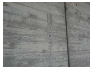
外壁のひび割れ
