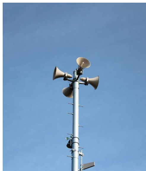
町の防災無線設備。いざというときに住民に迅速に情報を伝達し、住民の安全を守る
