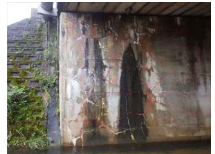
写真3 アル骨によるひびわれ (成分分析、残存膨張量試験 等)
