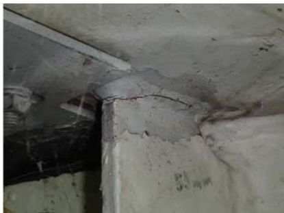
写真1 疲労による鋼部材の亀裂 (非破壊試験による亀裂確認 等)
