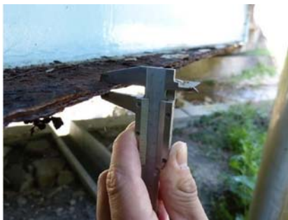
写真4 鋼部材の腐食 (残存板厚測定 等)
