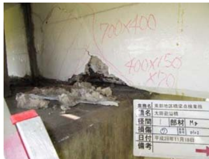
写真2 塩害による剥離・鉄筋露出 (含有塩分量測定 等)
