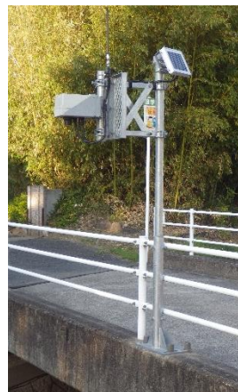
水位監視型水位計
