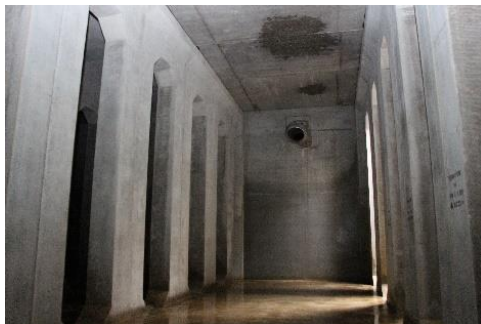
町社会福祉協議会駐車場ほか 地下貯留施設内部
