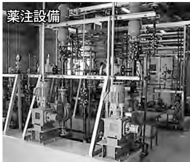
薬注設備 消毒剤(次亜塩素酸ナトリウム)で消毒・殺菌するための施設。
