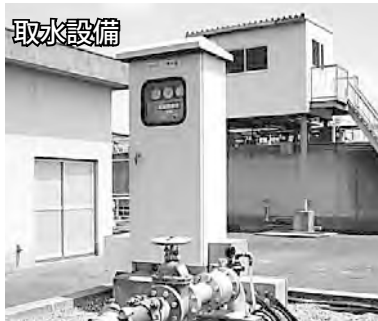
取水設備 浄水場の周りの深井戸からポンプで地下水をくみ上げます。
