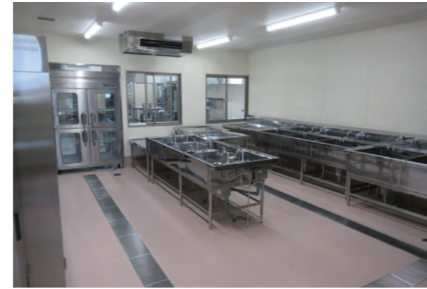
下処理室 食材の下処理を行う部屋です。下処理後の食材はカウンターを通して調理室へ受け渡しを行います。
