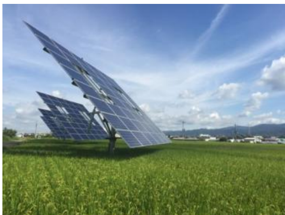
水田に設置した太陽光発電パネル
